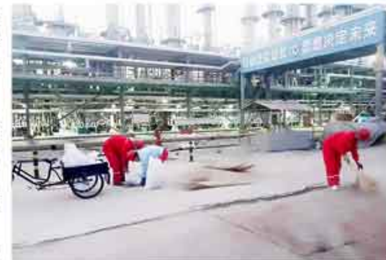
(图为生产运行中心丙班人员进行现场卫生清理)
